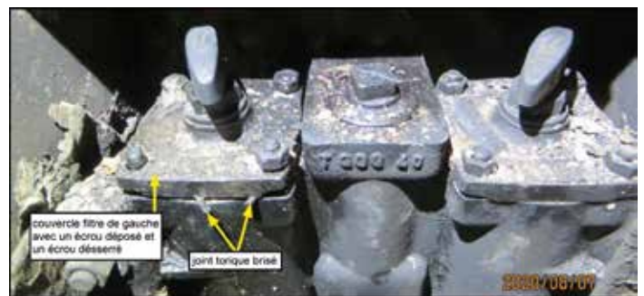
Figure 6 : Filtres à gazole du GE1 après l'incendie
