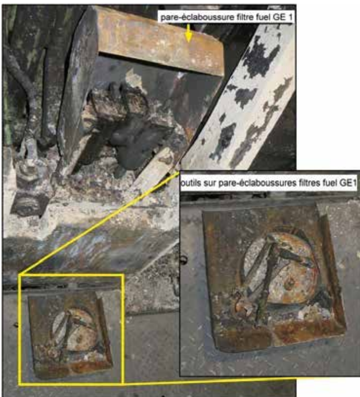
Figure 4 : Après l'incendie, pare-éclaboussures du filtre à carburant GE1 avec outils déposés dessus
