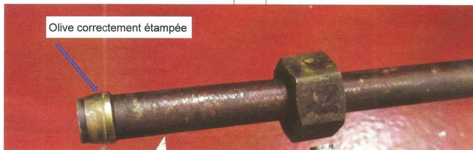
Détail en coupe du montage typique de compression et du corps (dessus). Olive correctement étampée sur la vieille section de la tuyauterie de retour de fuel-oil de l'APL « President Eisenhower » (en bas). (Source de la figure du haut : Worldwide Fittings)
