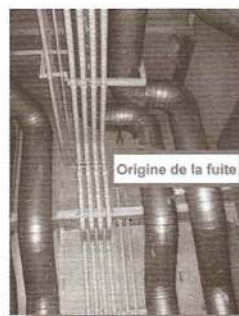
Joint à bride sur le tuyau de trop-plein avec les écrous desserrés, situé au-dessus de l'arrière du collecteur d'échappement du moteur principal.
