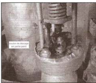
Sur le boulon bloquant la vanne en position ouverte, la partie peinte montre l'ancienneté du montage.
