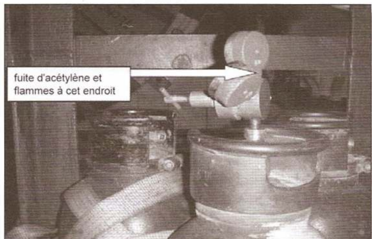
Montage défectueux du manomètre acétylène du régulateur
